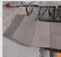
Hängedecke vom Trockner Voûte suspendue de sécheur
