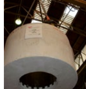
Castable lining of snorkel Garnissage de plongeur en béton
