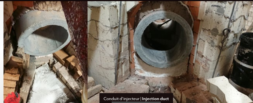
Conduit d'injecteur | Injection duct
